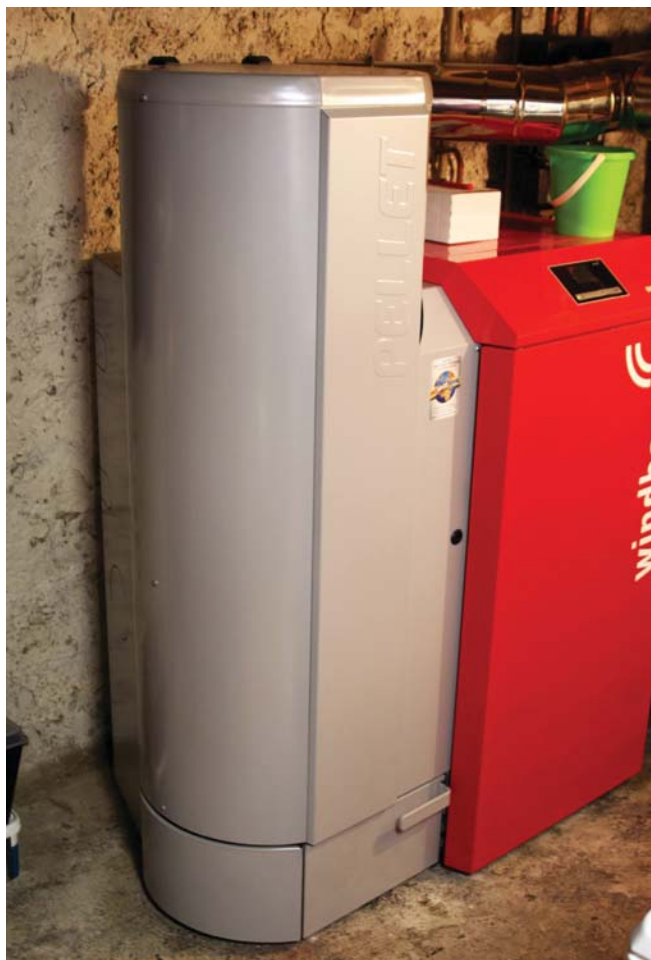
Chaudière à pellets dans une maison de CEINTREY Photo Damien DEMOUY et Julien FOUGERIT
