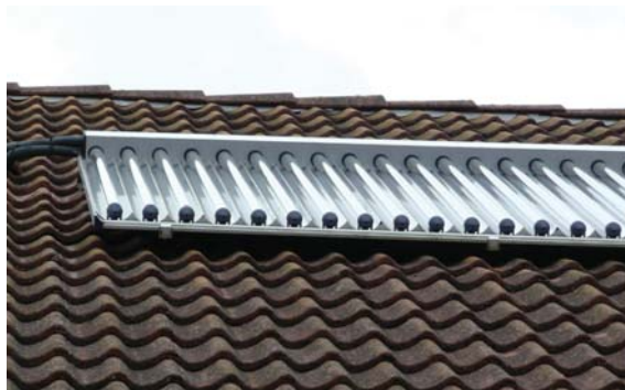
Panneaux solaires pour l'eau chaude sanitaire © CAUE 54
