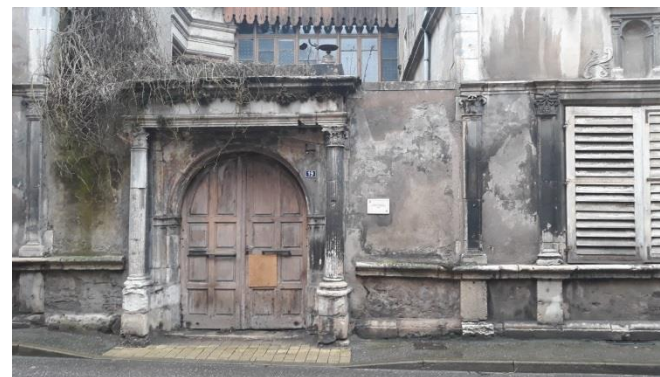
Bâti ancien dégradé dans le centre-bourg de Vézelize (source : Citadia, mars 2019)
